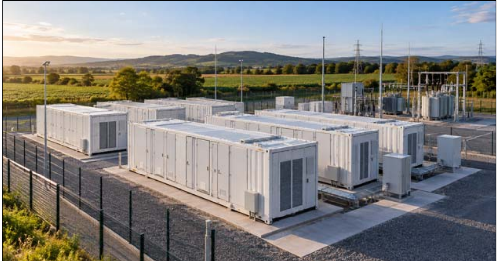
Batteriespeicher sind für die Energiewende unverzichtbar.
